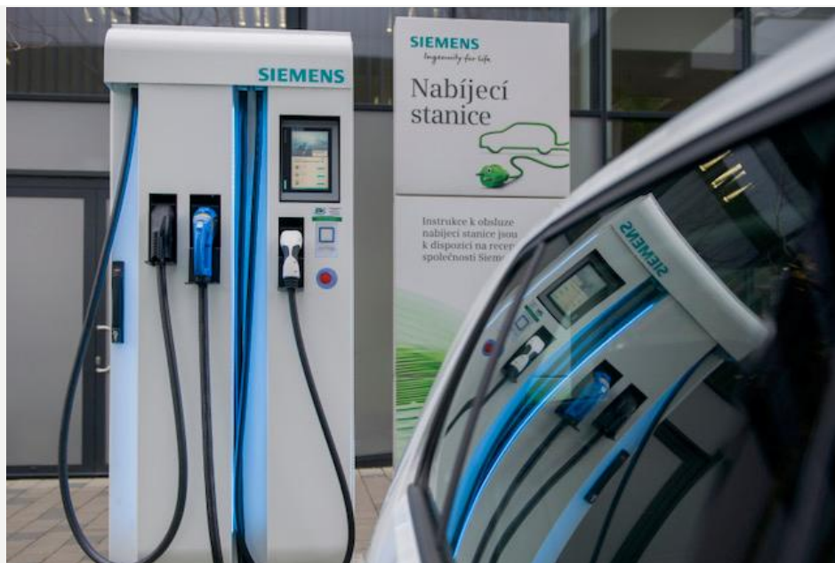
50 kW DC nabíjení v SIEMENS, Praha - Stodůlky
